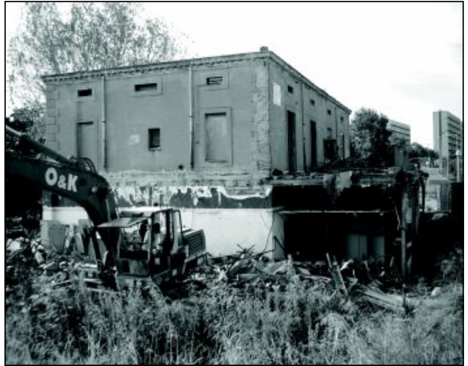
Can Serra lleva en periodo de remodelación desde principios de octubre. El año que viene se levantará el nuevo edificio que albergará el Museu d'Història de la Immigració a Catalunya. MS
