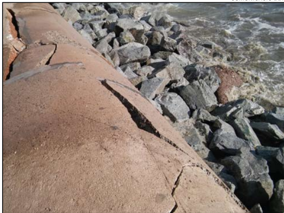
El temporal que va provocar molts maldecaps durant el passat cap de setmana va provocar danys al col·lector-interceptor de Llevant de la platja de la Mora de Badalona. Aquest col·lector és el que porta les aigües residuals de Badalona i Montgat cap a la depuradora del Besòs, al terme municipal de Sant Adrià de Besòs. L'onatge provocat pel temporal ha aixecat roques de més de 50 quilos, que en impactar contra aquesta infraestructura, hi han provocat esquerdes i l'han deixat malmesa.
