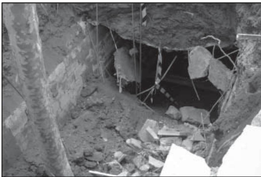
Uno de los parterres de nueva construcción de la calle Berenguer se vino abajo el lunes 29 de octubre sin que se produjeran daños personales. MS
