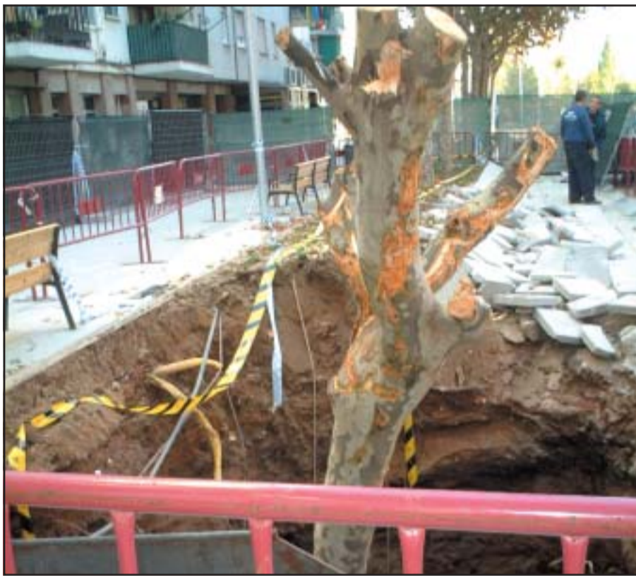
El socavón de la calle Berenguer sorprendió a los vecinos del barrio del Besòs.
